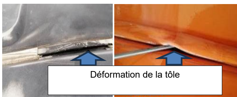
Figure 5 : Problème de déformation de la tôle
