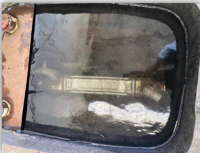
Photo 2 : Glacière dans le réservoir d'eau
